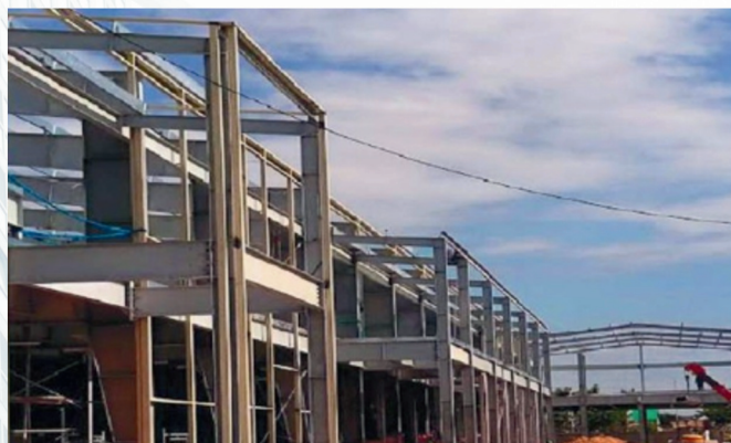
NHÀ MÁY DAEHA CABLE VIETNAM
